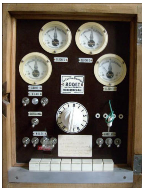
Le tableau électrique installé en 1961
